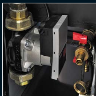
Pompa per circuito di riscaldamento
